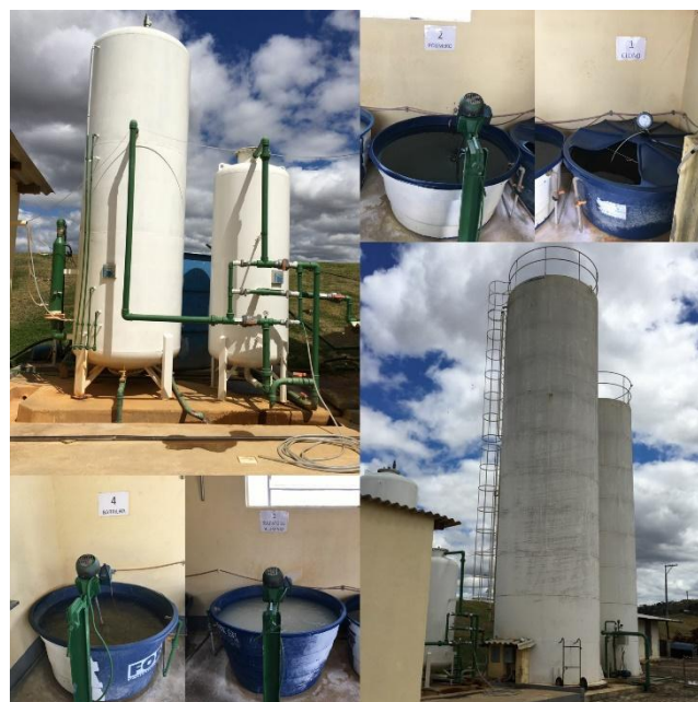
Figura 01: Estação de tratamento de Água (ETA). Fonte: Dados da pesquisa.
